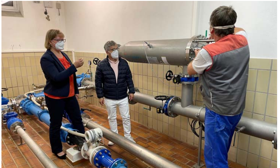
Verbandsvorsitzender Ehrler und Geschäftsführerin Schirmmacher bei der Besichtigung der neuen UV-Anlage im Wasserwerk.
