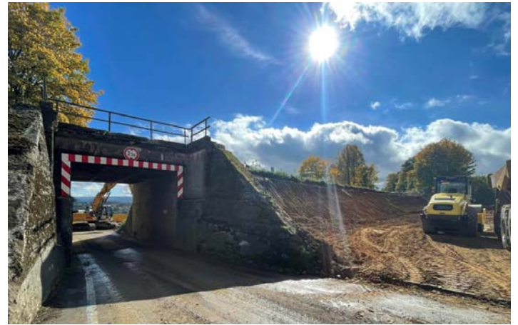
Die alte Brücke bei Metzlesdorf war baufällig.
