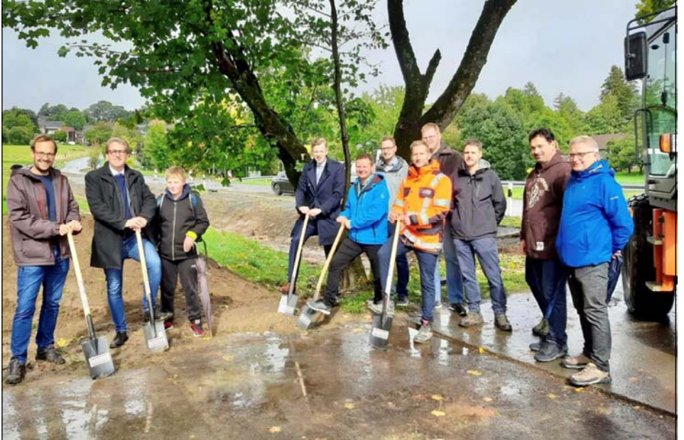
Der Bürgermeistervertreter Markus Käs (zweiter von links), weitere Gemeinderäte, Vertreter der Baufirma und Landrat Dr. Oliver Bär (Bildmitte) beim ersten Spatenstich.
