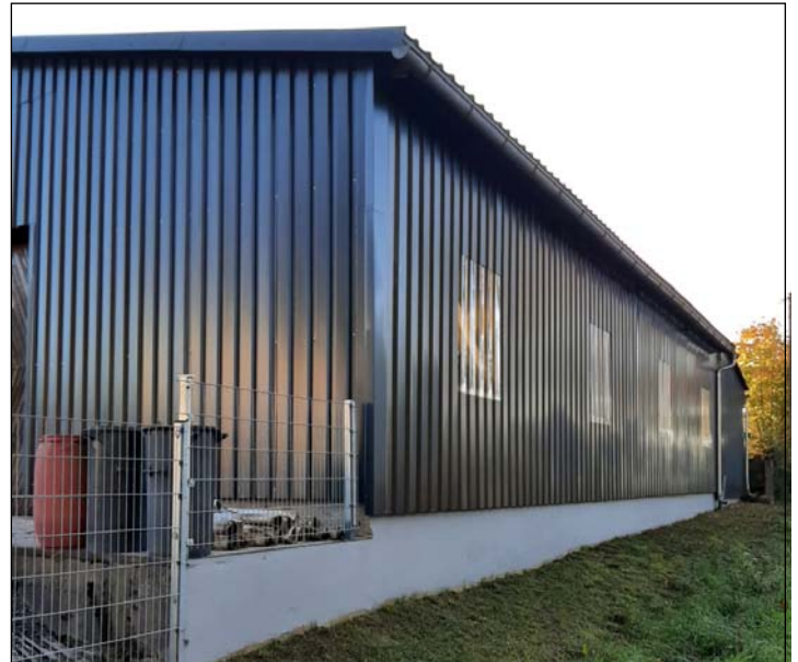
Auch die Lagerhalle wurde erfolgreich außen neugestaltet. Die Verkleidung mit Trapezblech schützt vor Wettereinfluss und verschönert zusätzlich die Optik.
