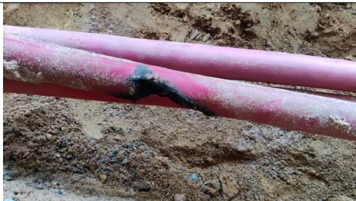
Das Bild zeigt den Kabelschaden an der Leitung zum Wasserwerk vor der Reparatur.
