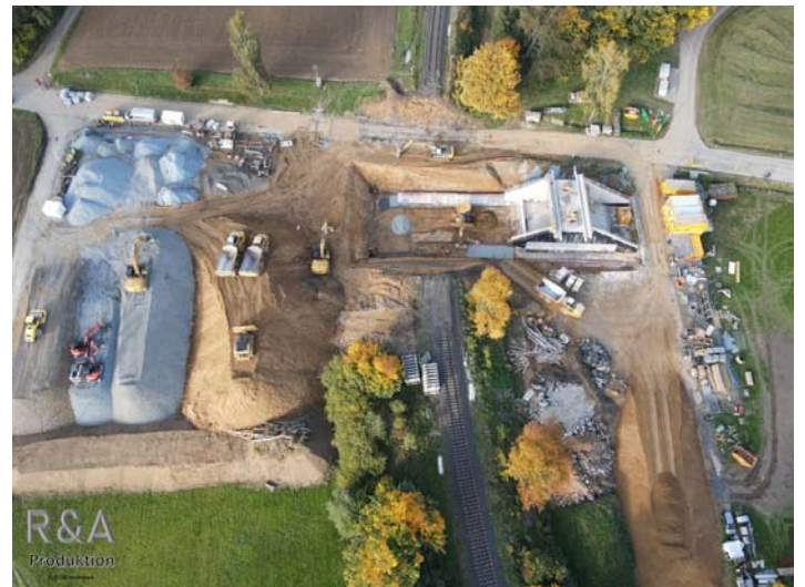
Die alte Brücke ist abgerissen und die Strecke für den Einschub der neuen Brücke vorbereitet.
