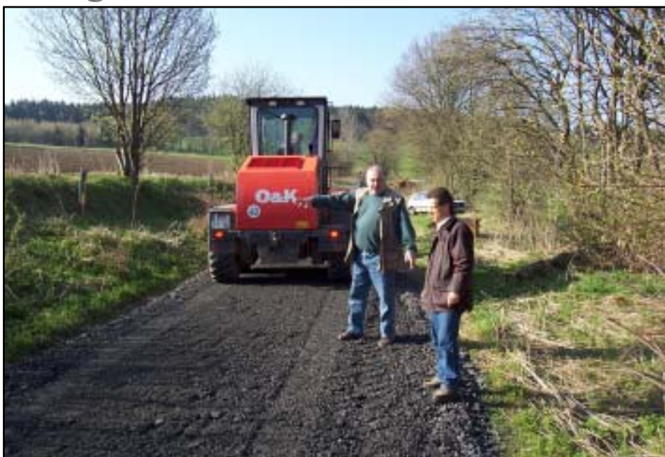
Die Bauarbeiten an den Verbindungsstraßen nach Rindlas sind im Gange. Mit schwerem Gerät wurde bereits eine neue Oberfläche aufgezo-gen. Bürgermeister Karl Philipp Ehrler (rechts) und Arnold Fischer, der die Arbeiten vor Ort leitete, informierten sich über den Baufortschritt.
