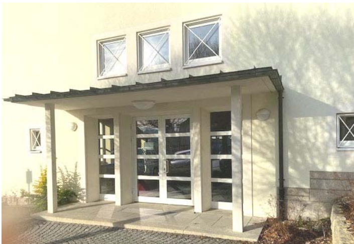
Der Zugang zur Turnhalle, die auch als Wahllokal den Bürgerinnen und Bürgern zur Verfügung steht, wird durch einen ebenen Zugang und Entfernung der Pflastersteine hindernisfrei gestaltet.
