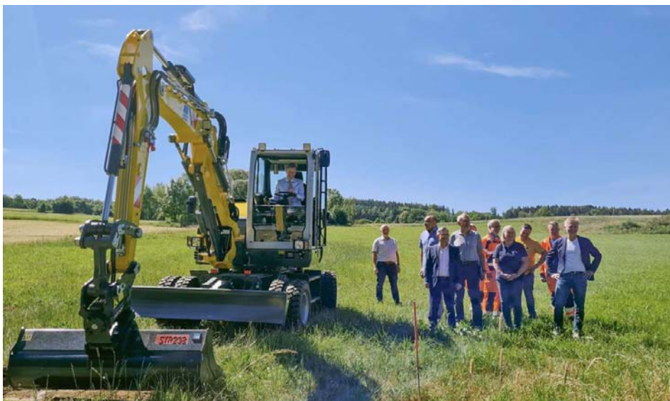
Die Verantwortlichen bei der Begutachtung der Radtrasse-Baustelle. Landrat Dr. Oliver Bär „startete“ die Baggerarbeiten. Foto: Schmidt
