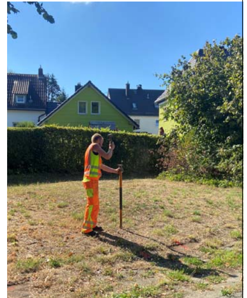
Mitte August definierte der Markt Stambach die genaue Position der geplanten Sammelschließanlage und freistehenden Reihenbügel.
